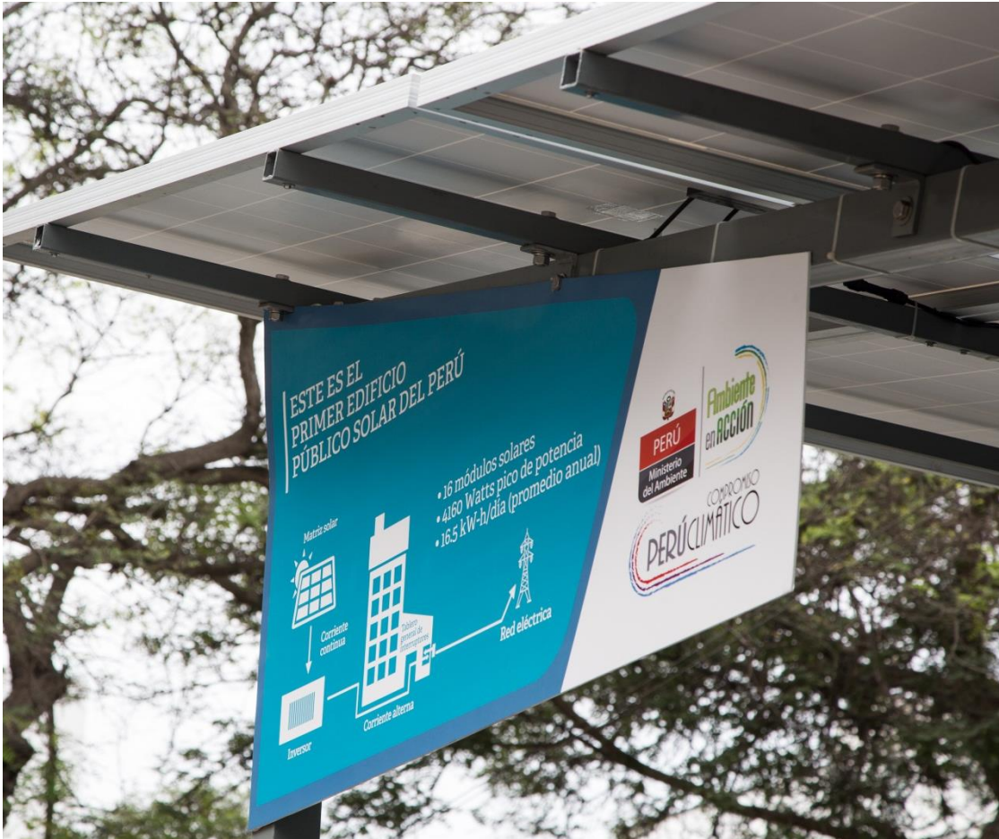
Paneles solares instalados en la sede central del MINAM (05/02/2016): Un módulo solar de 260 Watts pico de potencia.
