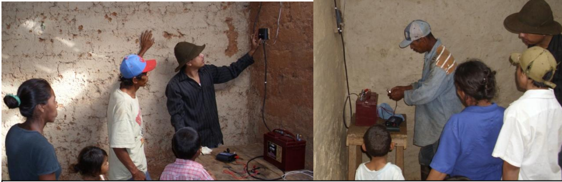
Izquierda: Profesor de la UNA, explica el funcionamiento del controlador de carga a una familia beneficiaria, Derecha: Un productor y su familia realizan pruebas de conexión y desconexión del inversor en presencia del profesor de la UNA. Comunidad Las Jaguas.
